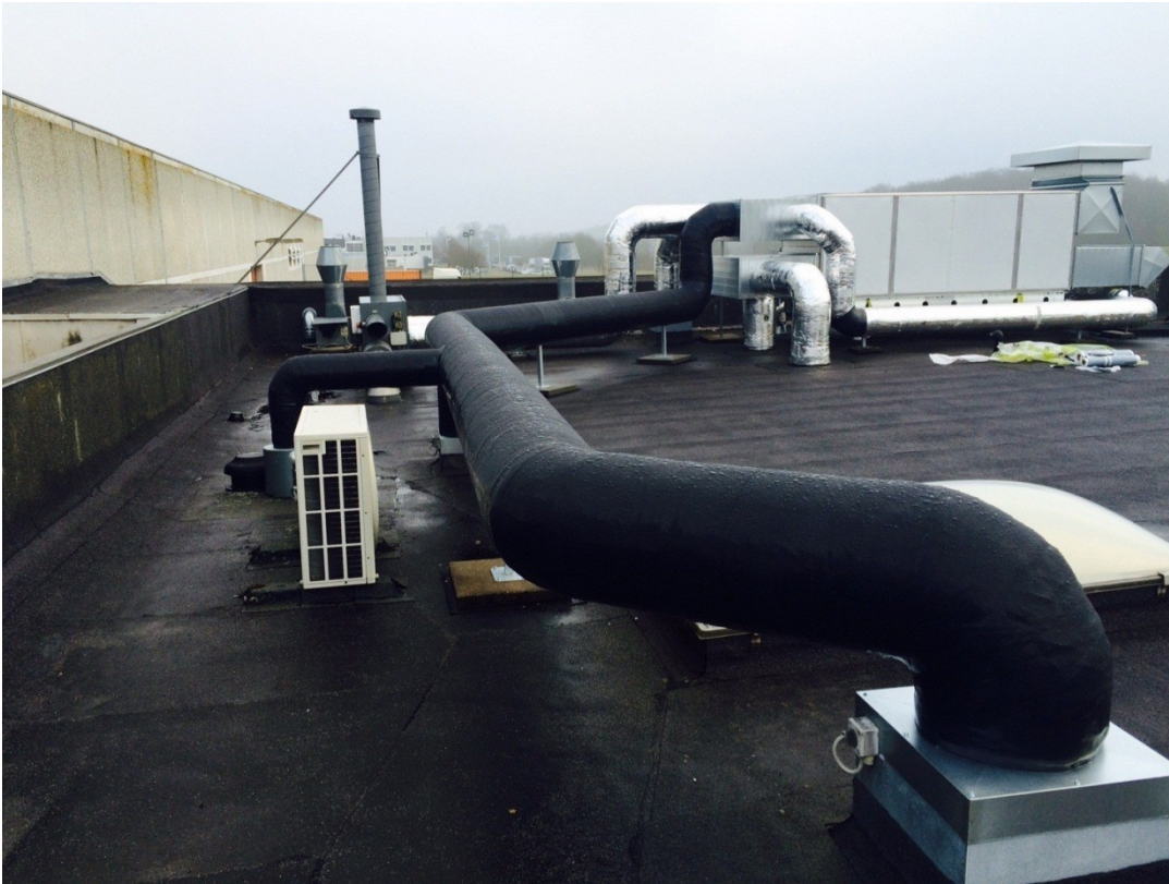
Ventilationsinstallation på tag afsluttet med Isocover, der giver en flot neutral finish.
